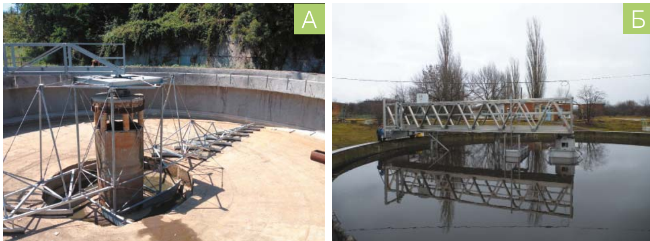
Рис. 2. Оборудование для отстойников А – ПРИМЕР ИЛОСКРЕБА, Б – ИЛОСОСНЫЙ МЕХАНИЗМЫ В РАБОТЕ
