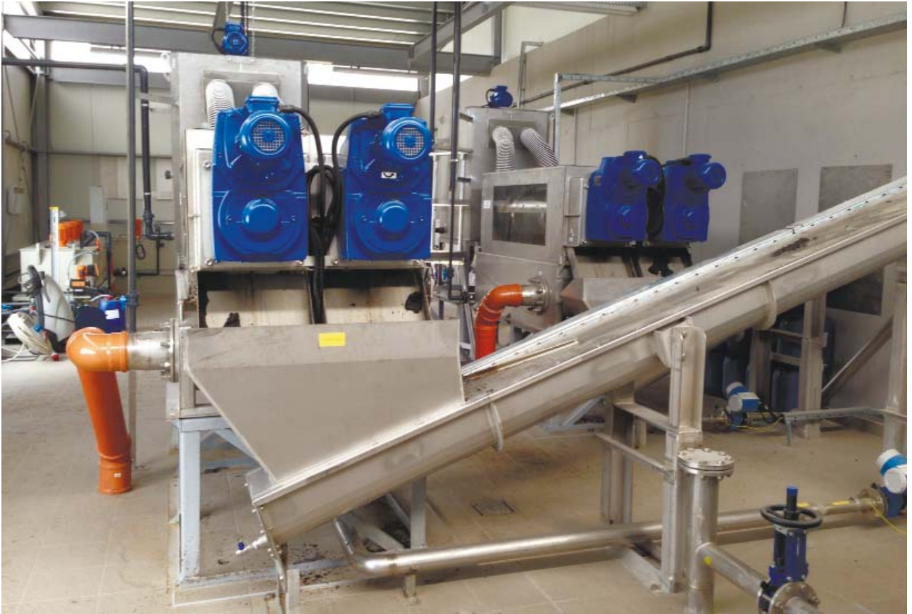
Рис.3. Комплекс механического обезвоживания осадка на базе мультидисковых шнековых дегидраторов (Озд, Венгрия)
